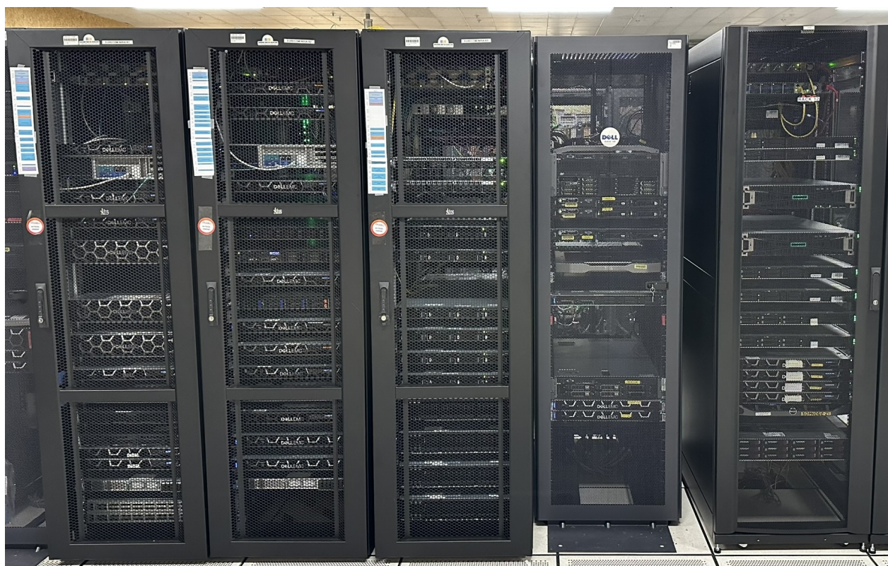
Figure 1: Baies de serveurs constituant le SophiaNode dans le data center d'Inria à Sophia Antipolis. La seconde baie en partant de la droite ne fait pas partie du matériel mis à disposition de SLICES-FR.
